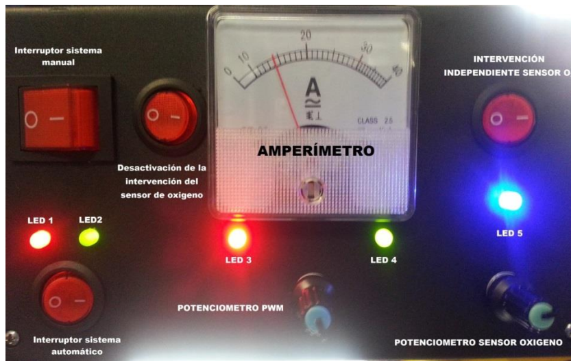
Ilustración 8: tablero de control
