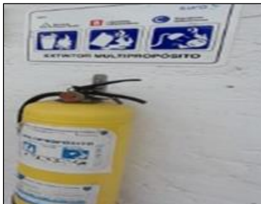
Figura 17. Extintores con Señalización
