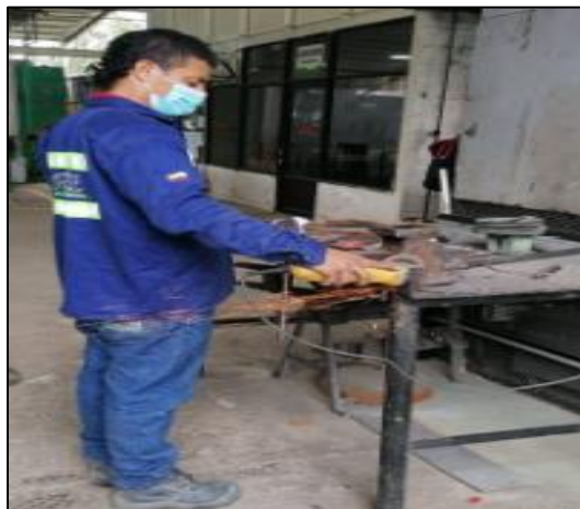
Figura 5. Actividad de cortes sin EPP
