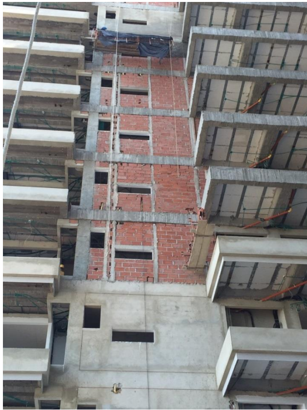
Imagen 14. Estructura, losas del 4 al 10 piso sin mallas de protección
