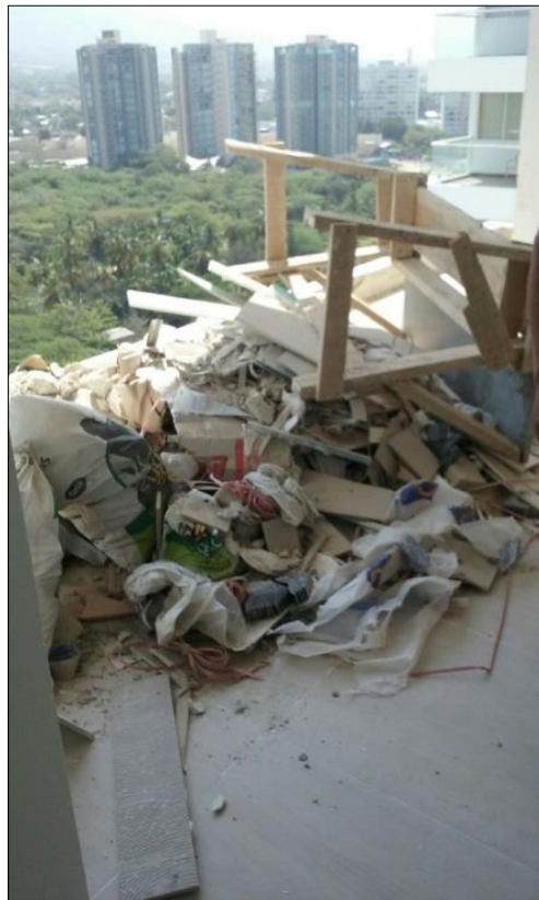
Imagen 8. Escombros en el borde de la losa
