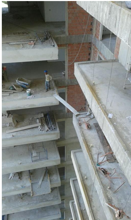
Imagen 4. Trabajos en borde losa sin aseguramiento de herramientas
