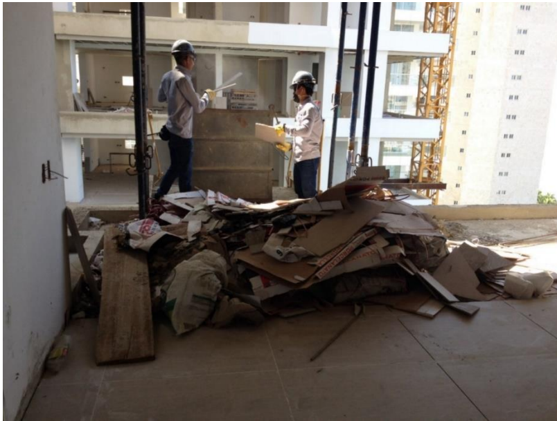
Imagen 5. Descargue de material, depósito de escombros en baches
