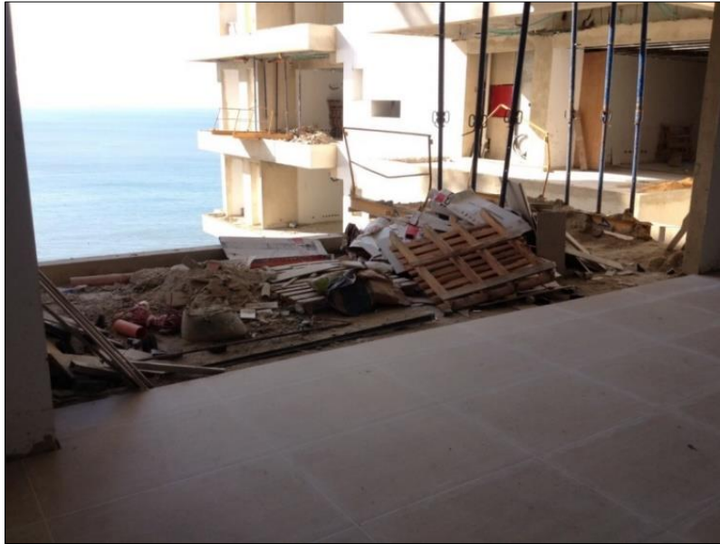
Imagen 7. Escombros en el borde de la losa
