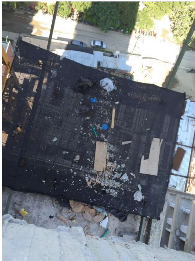
Imagen 11. Palomera (malla proteccion contra caida de objetos)
