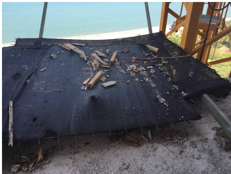
Imagen 12. Palomera (malla de protección contra caída de objetos)
