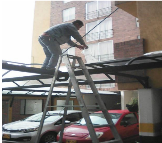
Fotografía No.11 Metálicas Gutiérrez área de montaje foto tomada en visita de campo por autores de la investigación
