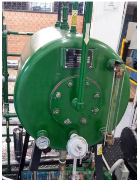
Figura 25. Tanque de alimentación de agua y retorno de condensados de la caldera [autores].
