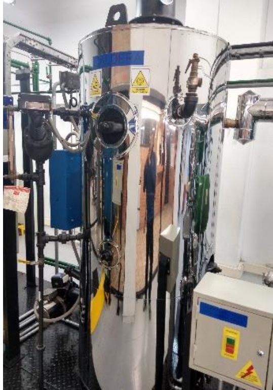
Figura 24. Caldera de la planta térmica de la universidad ECCI [autores]
