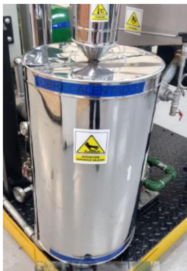
Figura 35. Sobrecalentador planta térmica piloto. [autores]
