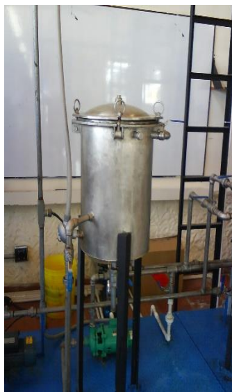
Figura 18. Tanque de agua caliente planta piloto de biodiésel [autores]
