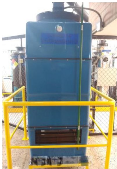
Figura 29. Torre de enfriamiento de agua de la planta térmica piloto [autores]
