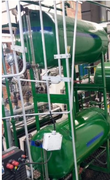
Figura 30. Tanques de agua fría y caliente [autores].
