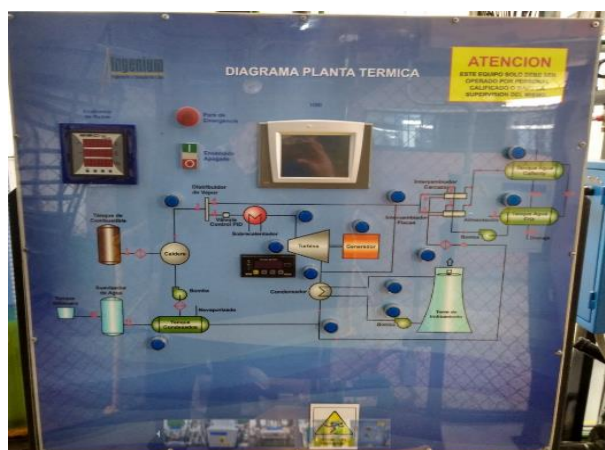
Figura 27. Tablero de control principal planta térmica piloto [autores]
