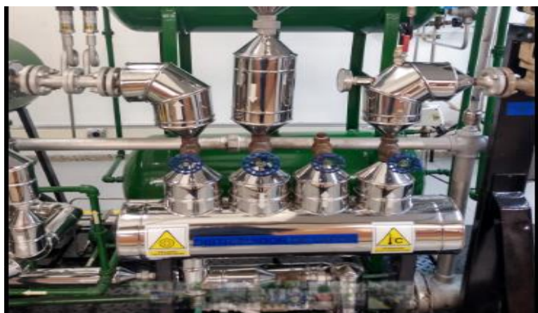
Figura 32. Distribuidor de vapor de la planta térmica piloto. [autores]
