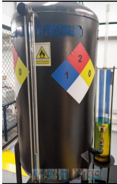
Figura 26. Tanque de combustible caldera de la planta térmica piloto. [autores]
