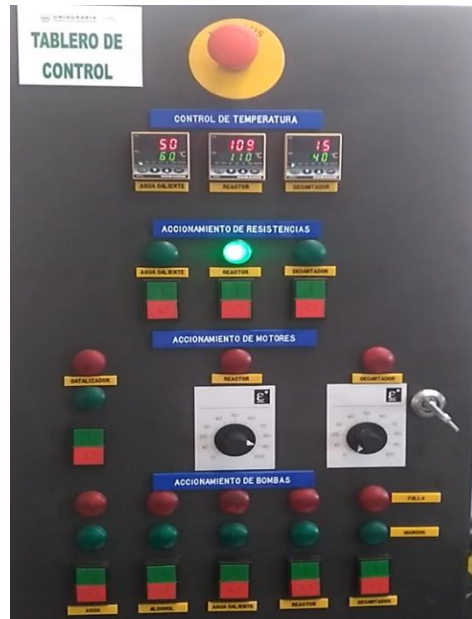
Figura 22. Tablero de control planta biodiésel – UNIAGRARIA [autores]
