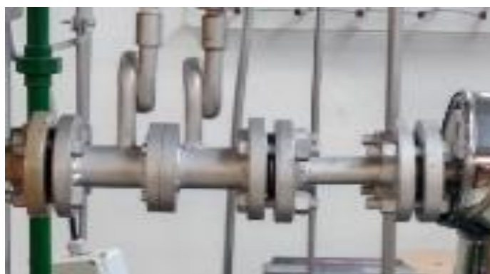
Figura 33. Caudalímetro de la planta térmica piloto. [autores]
