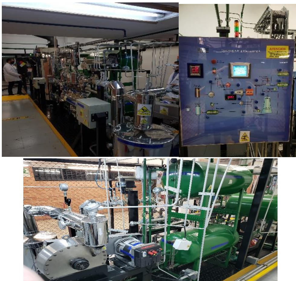
Figura. 9. Planta Térmica ECCI-1
