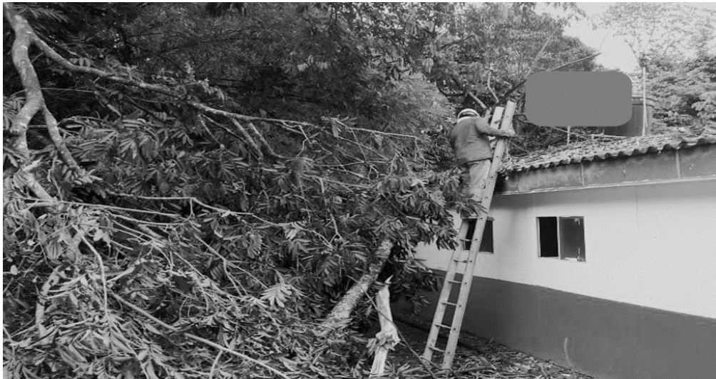
Figura 2 Uso de escaleras para ascenso
