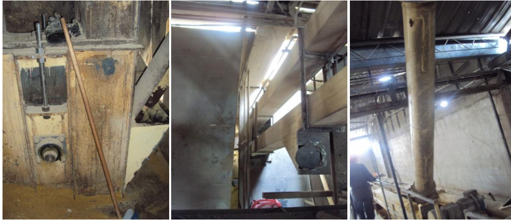
Figura 4.21 Elevador Soya Extruida
