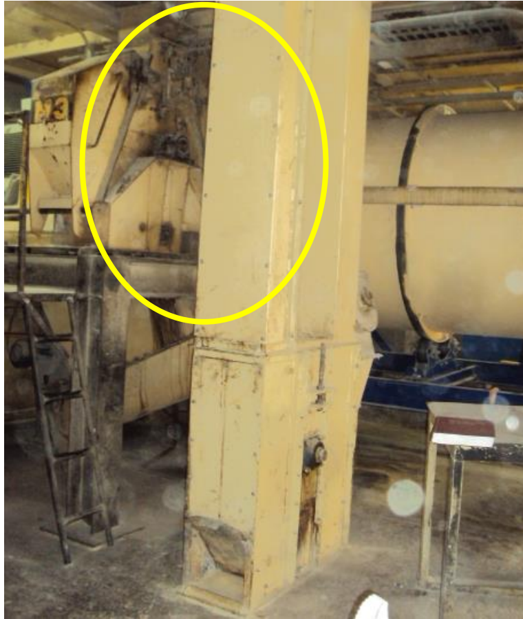
Figura 6.1 Espacio reducido entre molino y enfriador.
