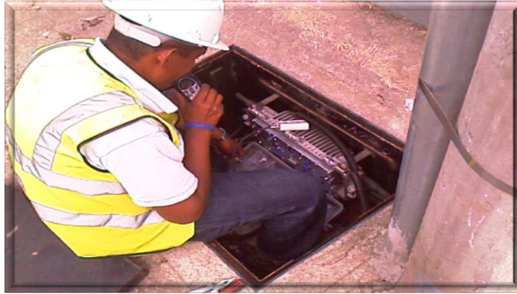
Figura 7. Cámara de Codensa
