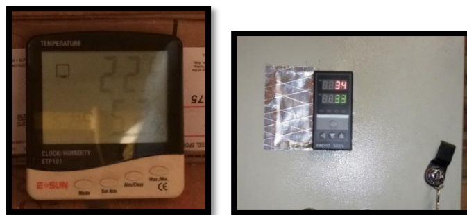
Imágenes 14 - 15: Termómetros de Sistema Antiguo y Nuevo de Calefacción
