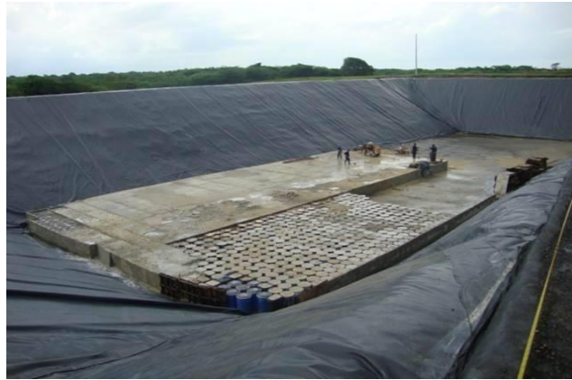
Imagen 79: Celdas de seguridad. (Tecniasma, 2015)
