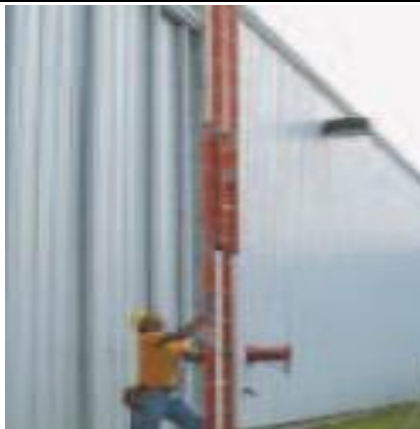
Figura 13: Forma incorrecta de retirar la escalera extensible
