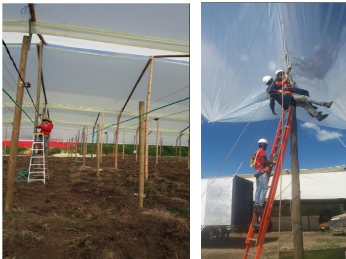
Imagen No.2. Montaje Invernadero tipo capilla en empresa del sector floricultor de Rionegro.
