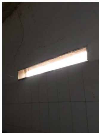
Imagen 6. Evidencia de sistemas de Ventilación en el Centro de Acopio Ubicado en el Batallón de Policía Naval Militar No. 70. Fuente.
