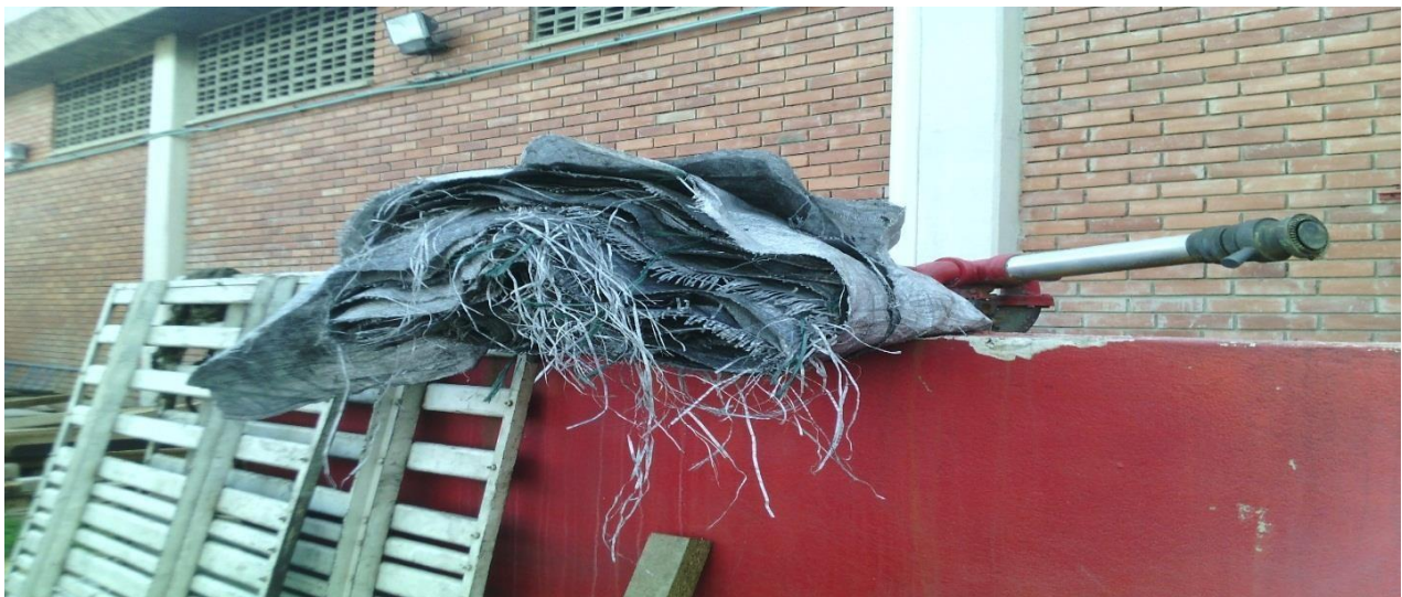
Figura 9. Tablero eléctrico sin protección. Condiciones de Seguridad-Riesgo eléctrico.
