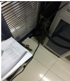
Cables sin canalizar consultorio medico
