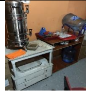
Área de cafetería en desorden y condiciones antihigiénicas
