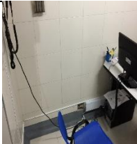
Cables sin canalizar en consultorio de fonoaudiología.
