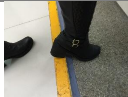
Desnivel de pisos.
