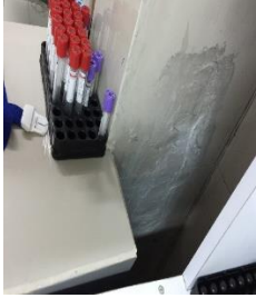
Humedad en la pared del laboratorio
