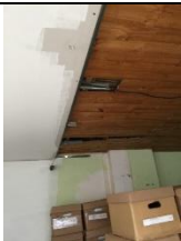
Archivo , techos rotos y desorden.
