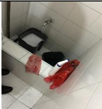
Cuarto de aseo, aguas estancadas.
