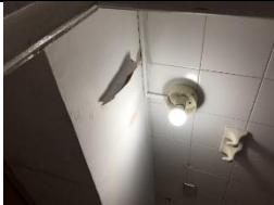
Techo baño roto.
