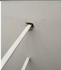
Baranda escalera suelta
