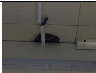
Condiciones electricas peligrosas, techos rotos.
