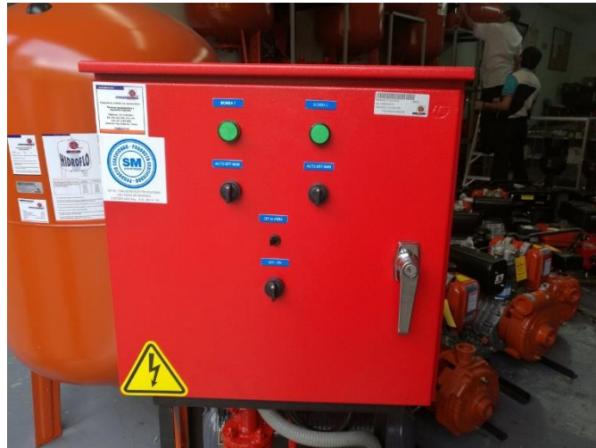
Imagen 7. Tablero de control, Fuente: Empresa IG IHM
