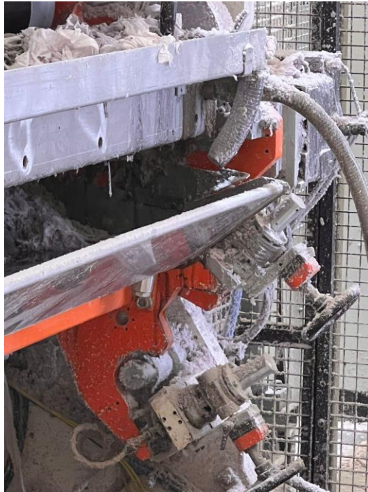
Figura 22 Manivelas de rodillo cliché en estado de deterioro
