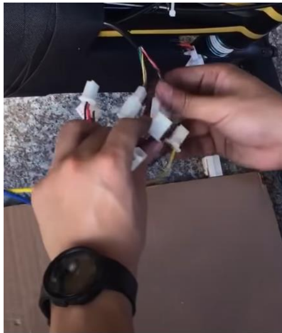
Ilustración 15 Instalación de conectores al banco de baterías. (De los autores)
