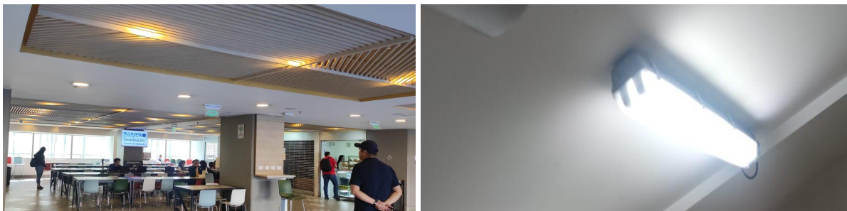
Luminarias de cafetería y cuartos técnicos
