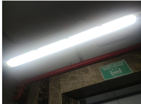
Luminarias herméticas del sótano del edificio
