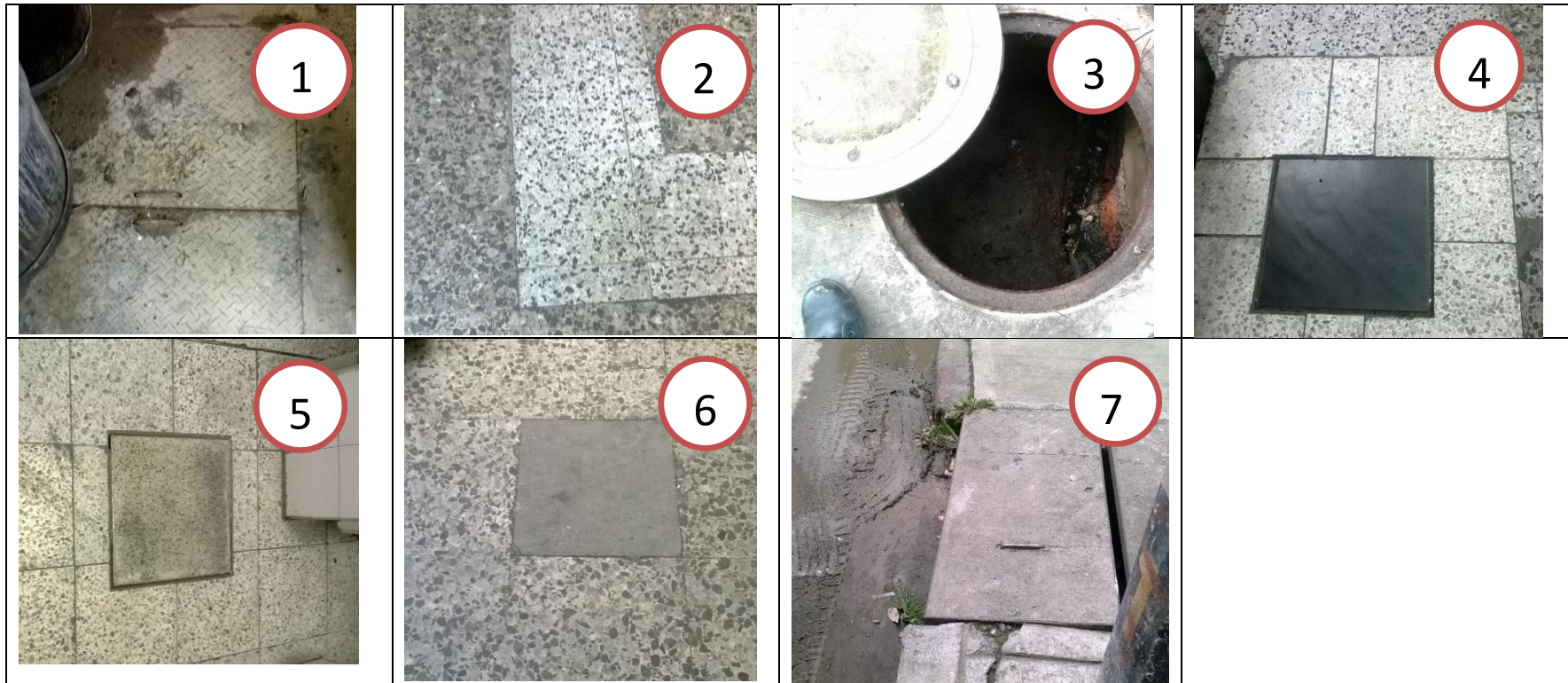
Ilustración 25. Registro fotográfico de las cajas de inspección ubicadas en la Planta Tubos para la toma de muestras
