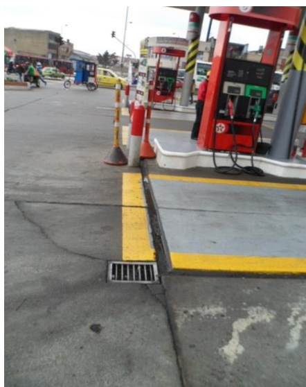
Figura4 Canaleta perimetral EDS 27
