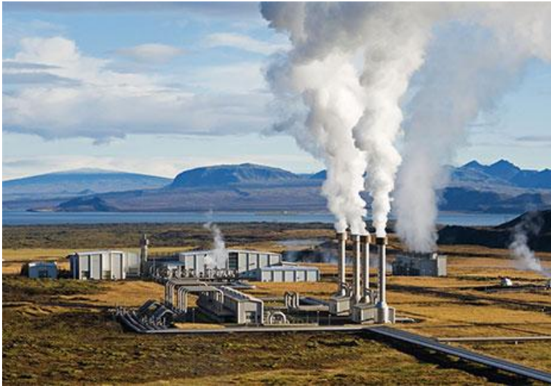
Figura 8. Central Eléctrica Geotérmica
