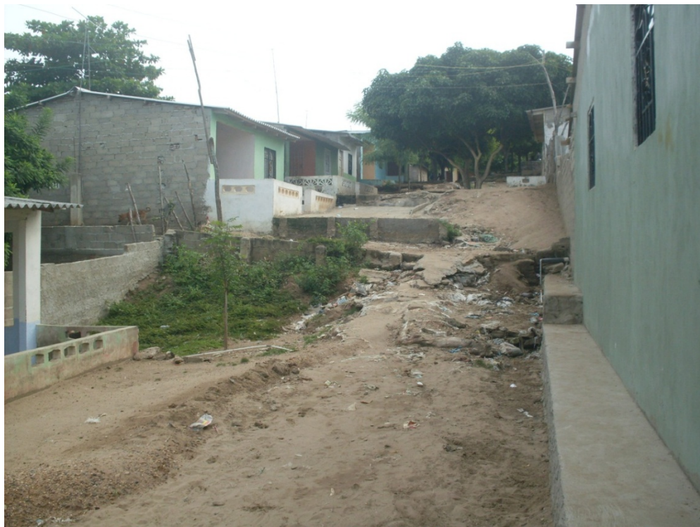
Figura 63. Estado de las vías y ausencia de canalización de aguas lluvias. Sabanalarga. Fuente: Archivo fotográfico de los autores.
