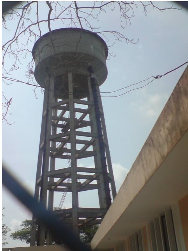
Figura 48. Tanques elevados de acueducto sin utilizar. Corozal, Sucre. Fuente: Archivo fotográfico de los autores.
