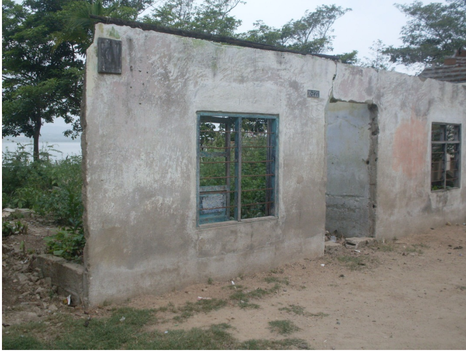
Figura 30. Estado de las viviendas posterior a la ola invernal. Sabanalarga, Atlántico. Fuente: Archivo fotográfico de los autores.
