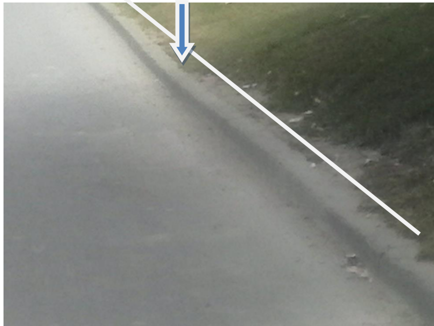
Fotografía 8. Hundimiento Calle 17 con Carrera 65. Fuente: Autores
