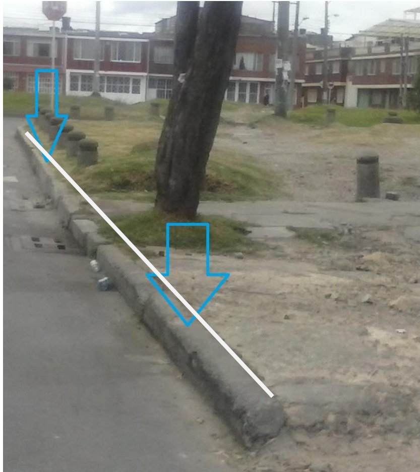
Fotografía 9. Hundimiento Carrera 5 con Diagonal 16. Fuente: Autores
