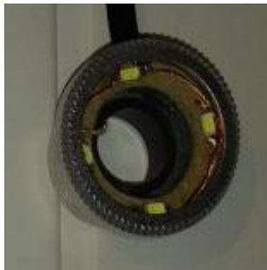
Figura. 32. Primer circuito con iluminación.
