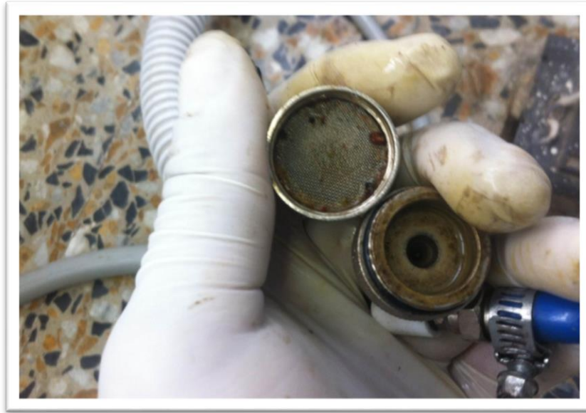
Figura 2: Filtro hidráulico de unidad odontológica. Fuente: Centro de salud ubicado en Vianí Cundinamarca.
