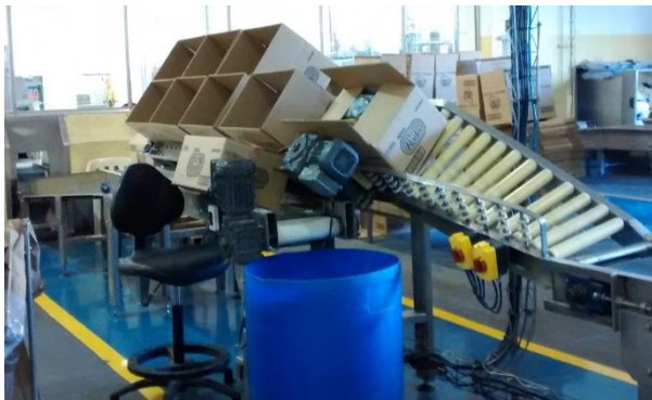
Ilustración 40. Transportadores de empaque y empuja caja, sala de embalaje. Fuente: Autor
