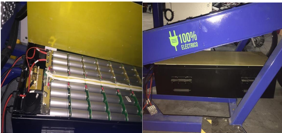
Figura 3. Banco de baterías
