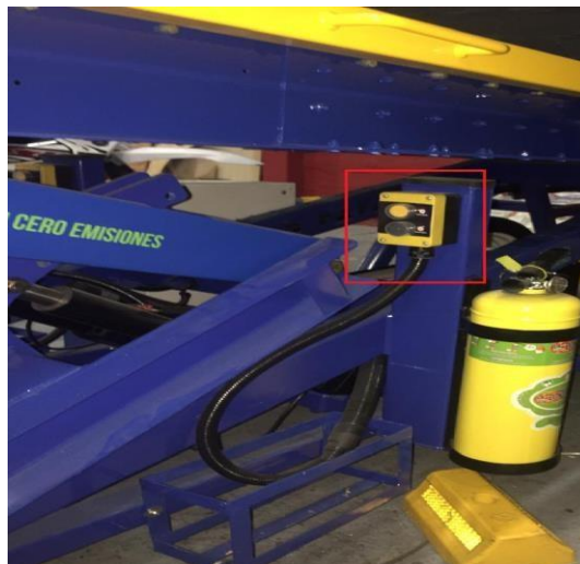
Figura 7. Botonera Ascenso y Descenso
