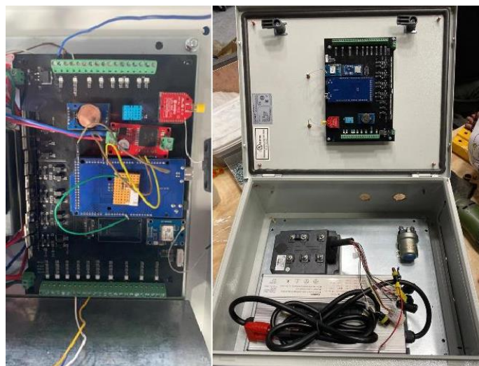
Figura 14. Tarjeta terminada y gabinete de control.
