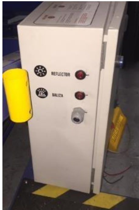
Figura 27. Activación iluminación y señalización.
