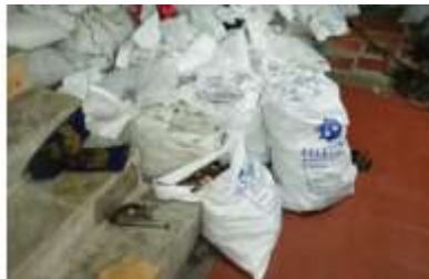
Ilustración 18 Pisos en mal estado
