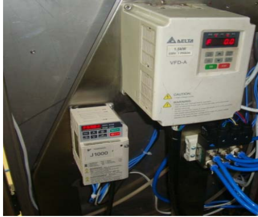
Figura 12. Variadores de Frecuencia
