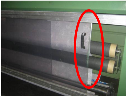
Figura 8 (Guardas de Seguridad)
