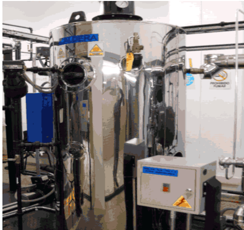
Figura 8. Caldera de vapor.
