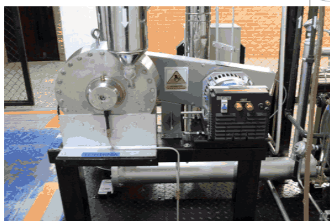
Figura 11. Turbina y generador.
