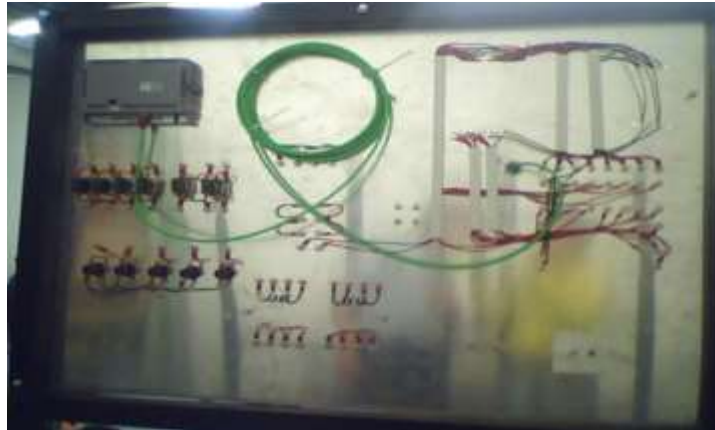
Figura 9. Fotografía de la distribución eléctrica del tablero. 19
