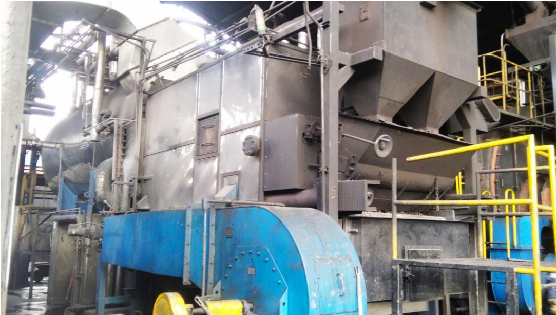
Ilustración 13: Caldera VR 700 BHP parte trasera
