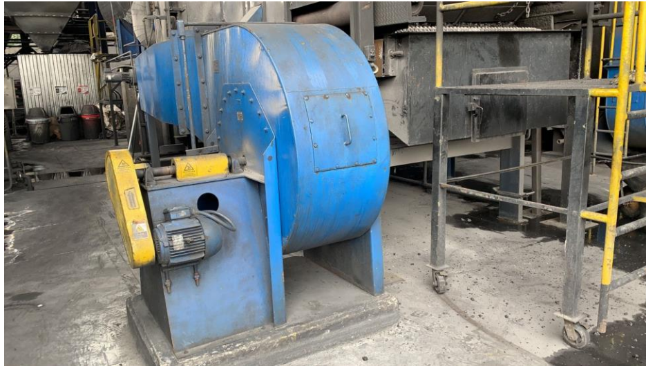
Ilustración 11: Ventilador tiro inducido
