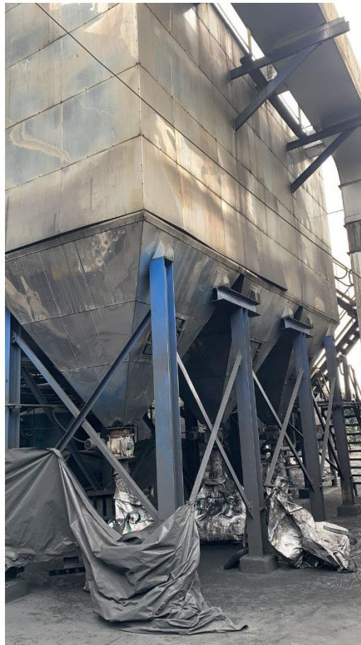
Ilustración 5: Filtros de mangas
