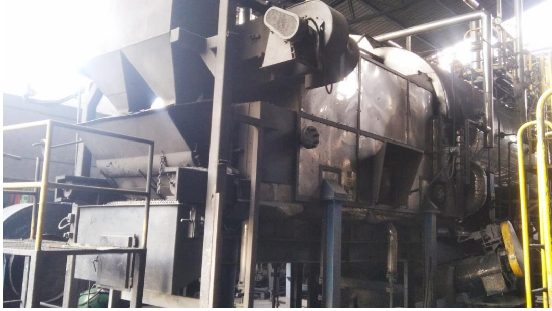
Ilustración 12: Caldera VR 700 BHP parte frontal
