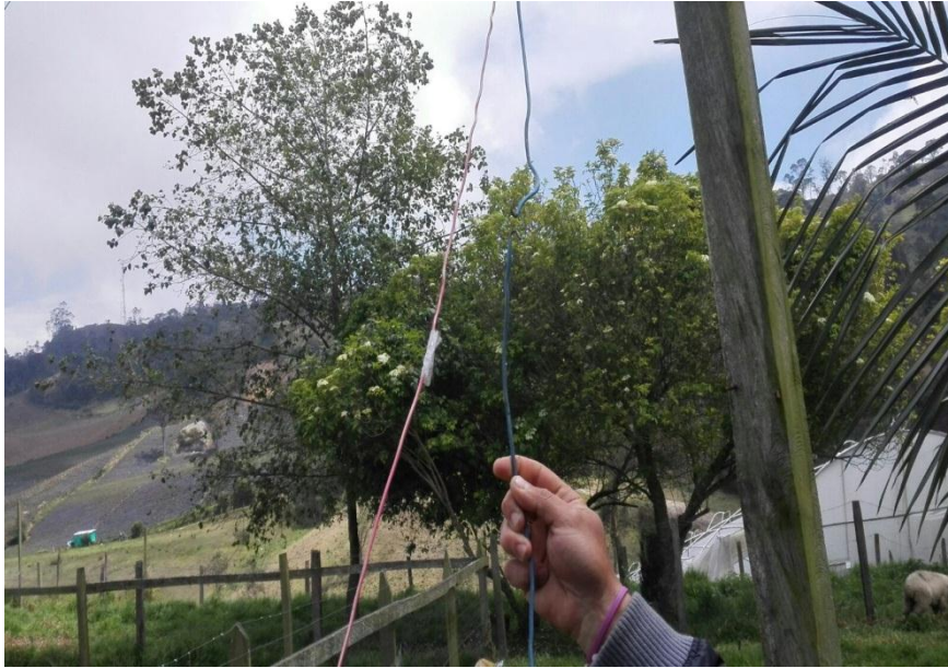
Figura 11. La imagen evidencia el riesgo eléctrico debido a la indebida ubicación de cables.
