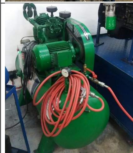
Figura 16. Compresor de aire para alimentación de aire continuo para la activación del cilindro neumático del freno de ahogo.
