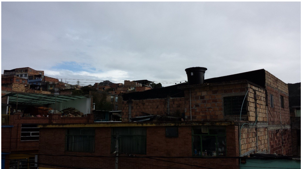
Figura 32 Área seleccionada para ubicar sistema energía fotovoltaica en COOPERMERCAR.
