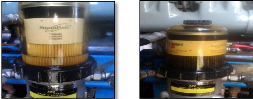
Imagen 4 Saturación de Filtros.
