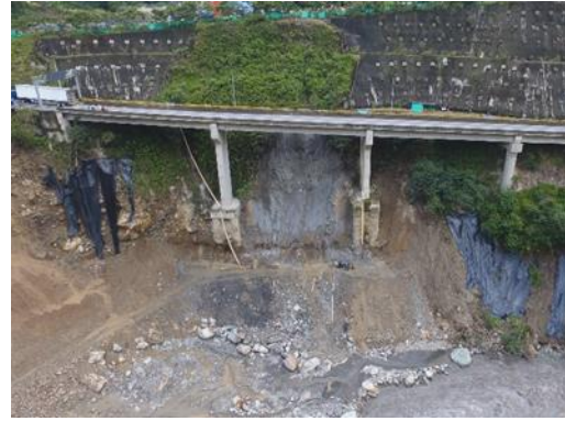
Ilustración 9. Socavamiento Puente en Guayabetal
