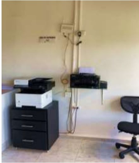
Ilustración 7Foto 4 Cableado expuesto
