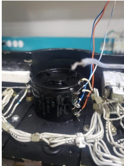
Ilustración 15. Potenciómetro palanca, fuente Propia.
