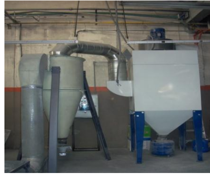
Figura 35 DESPUES Cabina de recuperación de material particulado
