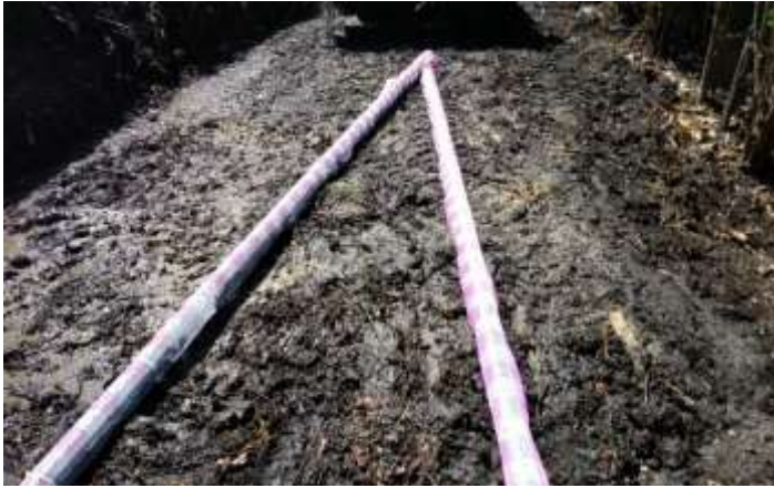
Ilustración 34. Tubos para recolección de lixiviados ubicados en forma de "V". Fuente: Autor
