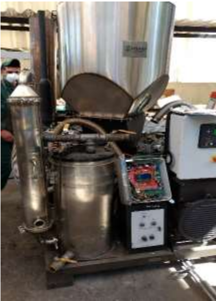
Ilustración 39. Operario encendiendo gasificador.
