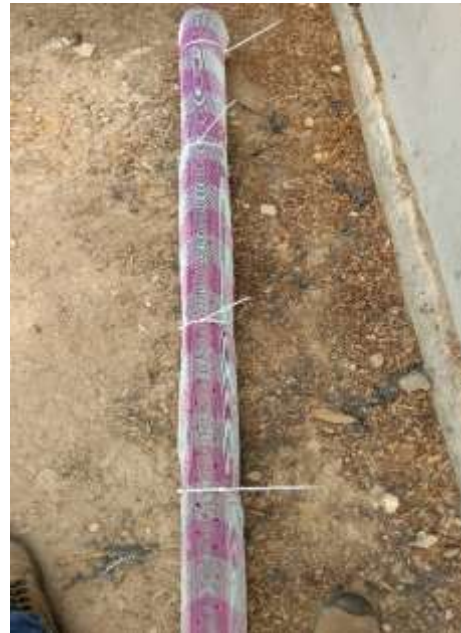
Ilustración 32. Tubo de lixiviado forrado con malla. Fuente: Autor
