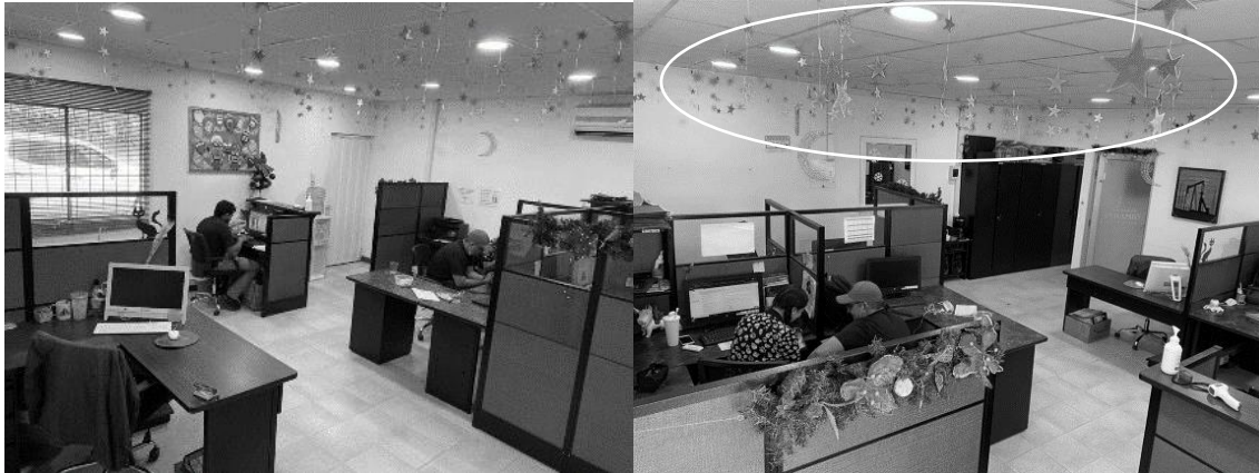
Imagen 11 Iluminacion de las oficinas administrativas
