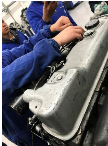
Ilustración 24.Desensamble de tapa válvulas. (Del autor).
